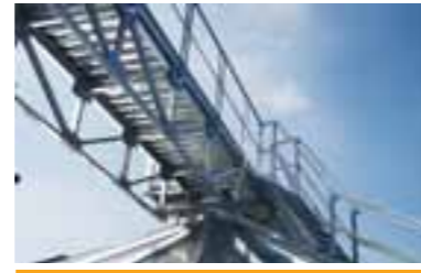
Lávky Široké a pevné lávky zajišťují snadný a bezpečný přístup k dopravní technologii a inspekčním otvorům. Montovaný systém s vlastní projekcí.
